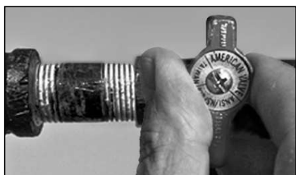
Figure 37 - Vanne de gaz manuelle en position fermée.
