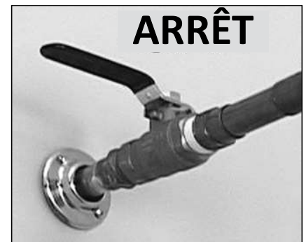
Figure 11 - Arrivée d'eau froide fermée.
