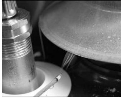
Figure 26 - Contrôler l'alimentation en air et l'évacuation des gaz de combustion du chauffe-eau pour s'assurer qu'elles sont correctes et suffisantes.
