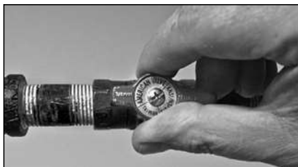
Figure 23 - Vanne de gaz manuelle en position ouverte.
